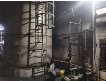
化纤公司实施远达制胶二车间糖浓缩膜滤液回用项目
